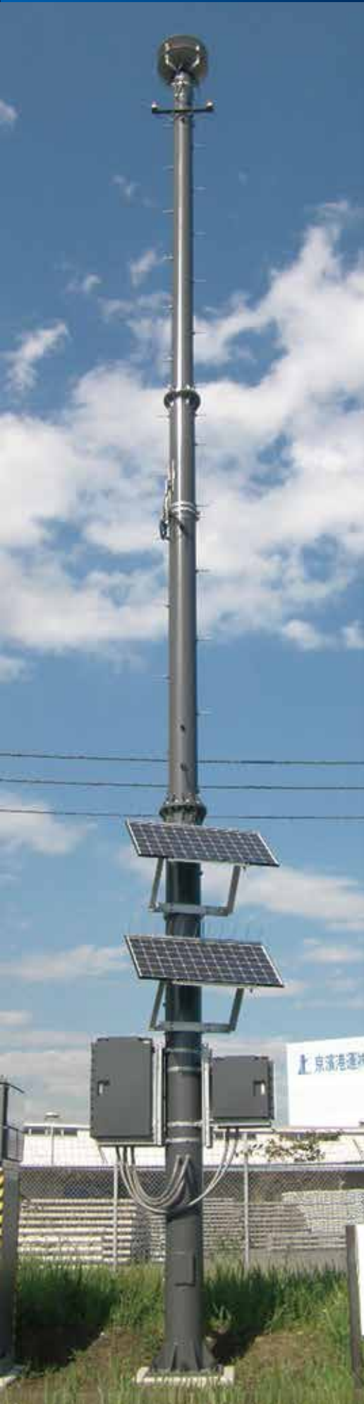
全方位型津波警報柱
