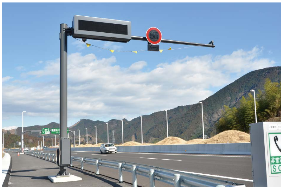
CCTV集合柱（NEXCO中日本）
